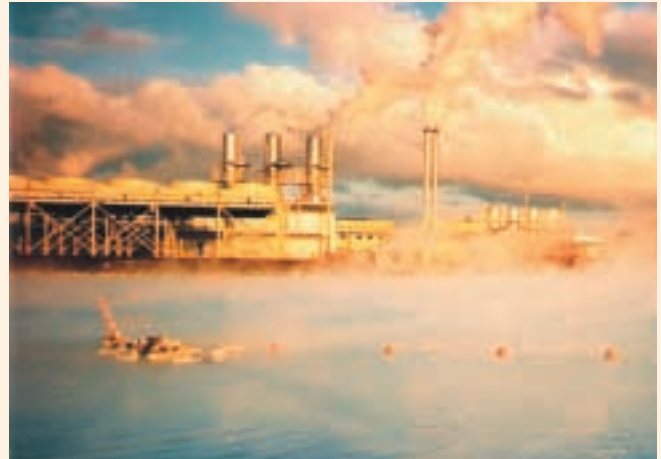
Εργοστάσιο παραγωγής ηλεκτρικής ενέργειας Svartsengi
